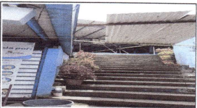
Foto 4: Gradas de concreto en mal estado con la lluvia se pone resbaloso
