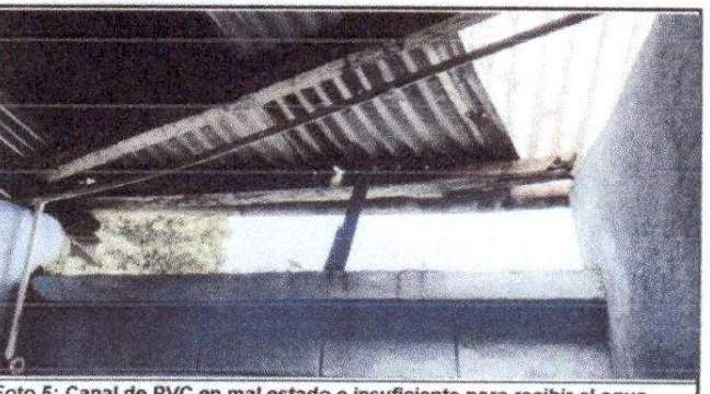
Foto 5: Canal de PVC en mal estado e insuficiente para recibir el agua, esta rajado
