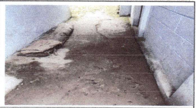
Foto 3: Piso de concreto peligroso cuando llueve
