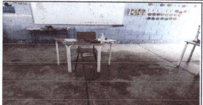
Foto 8: repello de pared de aula por humedad constante y esta dañando la estructura
