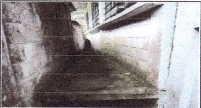
Foto 9: repello de pared por filtracion de agua hacia las aulas
