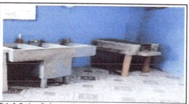
Foto 6: Cocina pila de concreto por higiene necesita colocar azulejo
